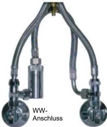
Foto: Unter einem Waschbecken eingebauter Zirkulationsregler
